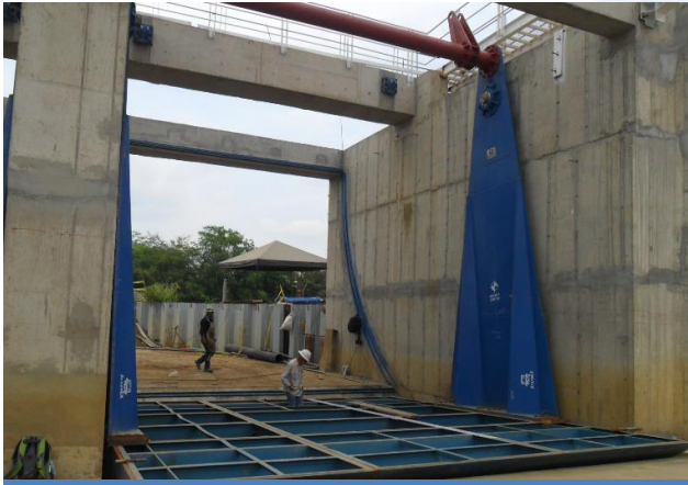
Compuerta Curva Emscali Estación Río Cauca Cliente – Construcciones CEIS
